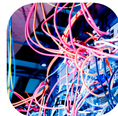
加速器の周辺には、データを送信する光ケーブルや送電線が絡み合っていた
